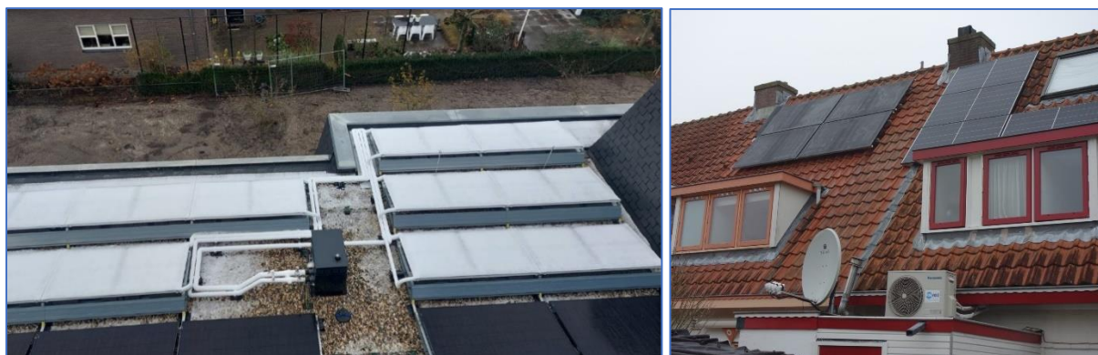
Figuur 26. Links. Van Triple Solar. Rijp op PVT. Bij deze foto zijn de verbindende leidingen te zien. Bij de planning voor de beschikbare ruimte moet met die leidingen rekening gehouden worden. Rechts. Op de linker tussenwoning vier panelen Triple Solar. Op de rechter woning gewone PV en airco.
