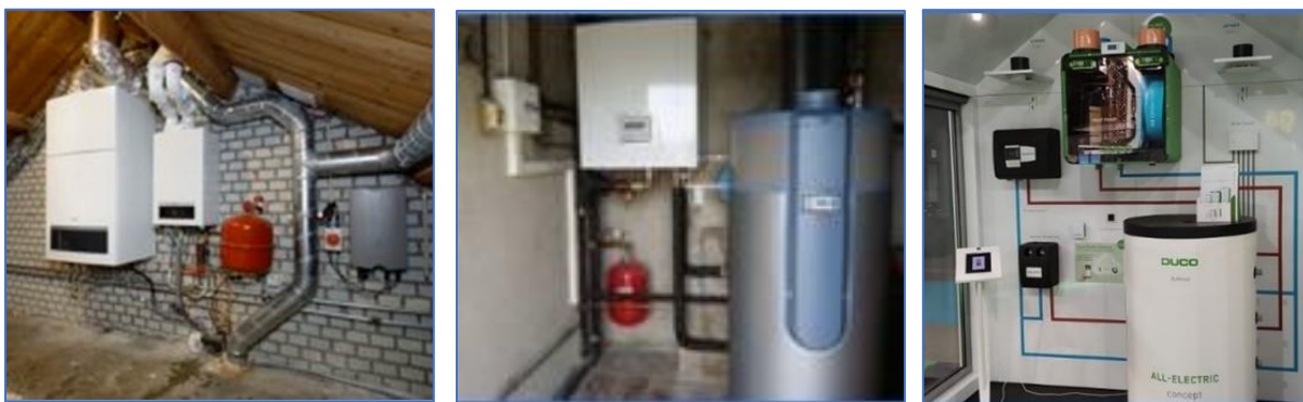
Figuren 50. Links . Hybride WP en de HR-Cv met rechts (grijs) de omvormer voor de PV. Midden . Voorbeeld van een Lucht-Water warmtepomp binnen opstelling met een buffervat. Rechts . Ducobox Eco met buffervat om koude-pieken op te vangen.
