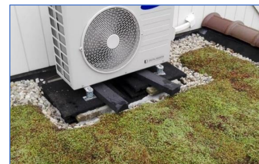
Figuur 39. WP op dakje met Sedum bedekking (Valliant). De harde muur achter de WP zal het geluid de tuin in sturen, maar de Sedum dakbedekking zal het geluid verminderen en de reflectie naar boven (slaapkamers) ook sterk verminderen.
