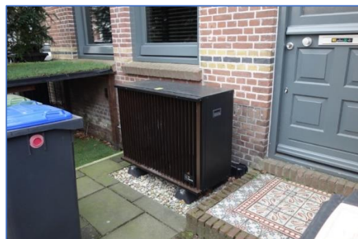
Figuur 37. WP aan de straatkant (Dewarmte). Door de plaatsing tegen de gevel zal het geluid naar de straat gaan. De erfgrans van de burens is pas aan de overkant van de straat minstens 8 m verder, waardoor de geluidsbelaasting daar veel minder zal zijn. Ontdooiwater zal in het grindbed wegzakken en ijs op de stoeptegels veroorzaken.
