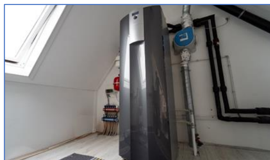
Figuur 22. Alpha innotec WZSV 63 op zolder. Deze kan een vermogen leveren van 6 kW bij een COP van 4,8 (35 °C) en een COP 3,7 (55 °C).
