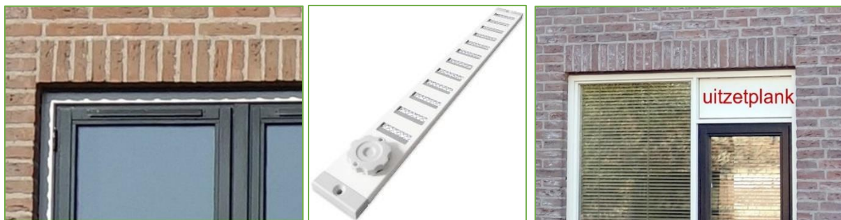
Figuren 27. Links : In deze eind jaren '80 woning zijn ventilatieroosters in het raamhout geplaatst die aan de binnenzijde afgesloten kunnen worden met een schuifje. Bij mechanische afzuiging zijn dergelijke roosters noodzakelijk om constant voldoende buitenlucht binnen te laten.
