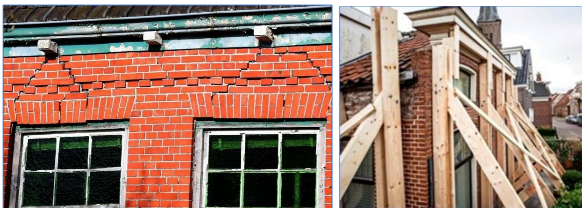
Figuren 35. Voorbeelden van beschadigingen en noodzakelijke stutten
