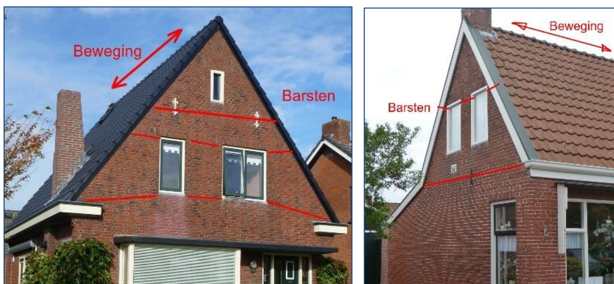
Figuren 9-3. Zadeldaken met potentiële locaties (rode lijnen) in de topgevels waar barsten kunnen/zullen voorkomen vanwege de beweging van de houten kapconstructie. Niet alleen door stormbelasting kan dit gebeuren, maar vooral door aardbevingsbelasting. De kleine zware dakpannen kunnen onderling wel iets meebewegen maar de gemetselde topgevels en schoorstenen niet, die barsten.
