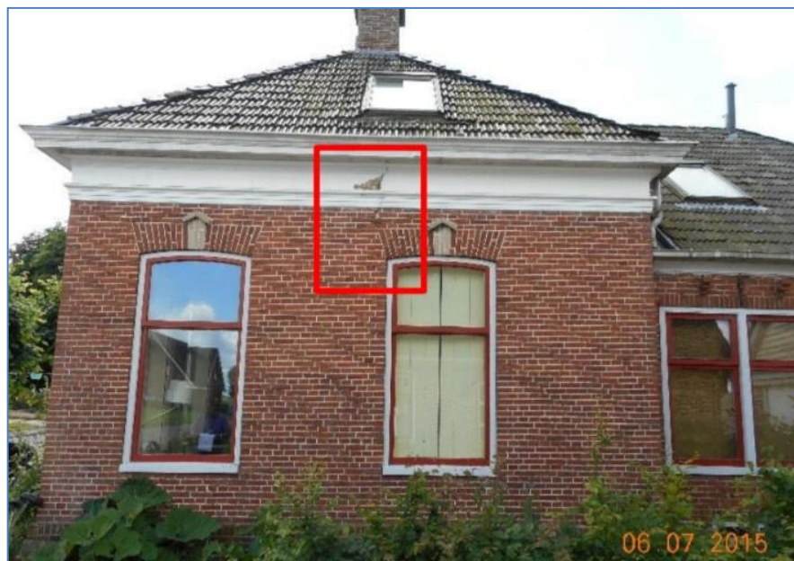
Figuur 9-9. Middengedeelte weggedrukt door de dakconstructie. De gevellijst is gebarsten vanwege de belasting van de kapconstructie en schoorsteen, gecombineerd met het gebrek aan een zolder vloerdiafragma. Het dakraam kan/zal een verzwakking van de kapconstructie zijn. Dat is van binnen te constateren. 3
