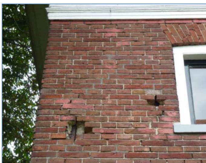
Figuur 9-8. Detailfoto van verroest balkanker. Door de expanderende roest zijn de bakstenen los van elkaar gedrukt. De beweging van de zoldervloer t.g.v. de beving veroorzaakte het uitdrukken van de bakstenen. Rechtsboven in deze foto is ook de scheur in de hanenkam te zien.
