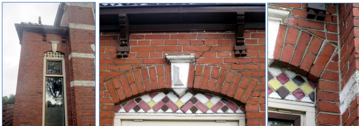
Figuren 7-52. Erker uitbouw zonder goede verbinding met de woning. De erker is onvoldoende sterk aan het gebouw gekoppeld, terwijl het raampenant erg smal is. Er zit geen trekwapening in of boven de toog.
