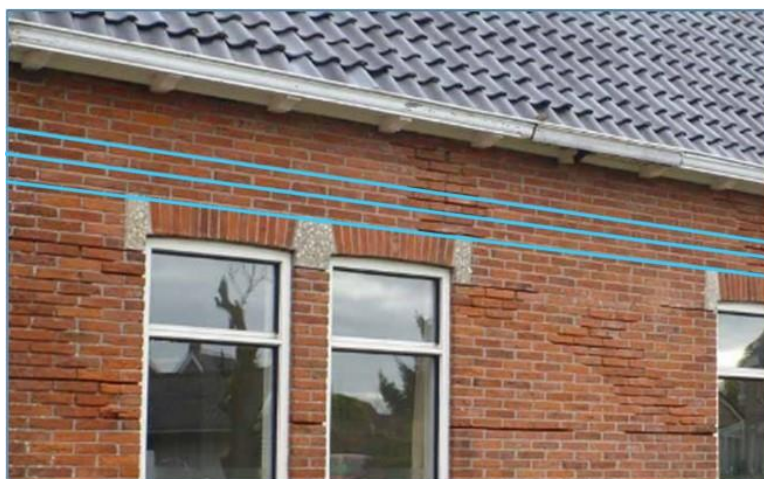
Figuur 7-7. Toepassing van een ringbalk d.m.v. lintvoegwapening. Bij slechts korte wapening stukken (midden boven de kozijnhoek) kan/zal na verloop van tijd naast het uiteinde van de wapening weer een nieuwe scheur ontstaan, omdat daar de trekkracht van het metselwerk niet verbeterd is. De toepassing in de praktijk was geen seismische versterken.
