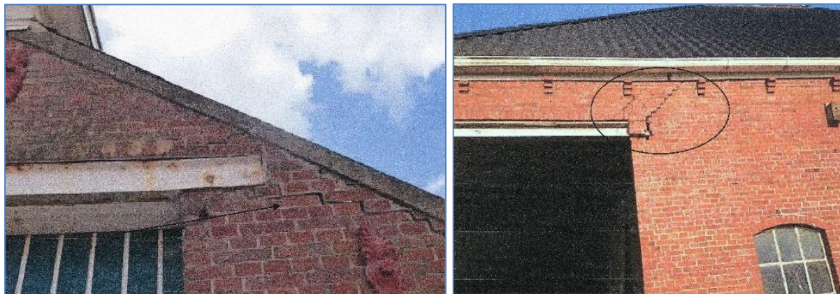
Figuren 7-36. Links: Horizontale thermische uitzetting drukt de smalle metselwerk rand naar buiten. Rechts: Het grote verschil in stijfheid tussen de twee metselwerk vlakken en thermische beweging van de balk veroorzaakten de scheuren. In deze situatie zou alleen een balk over de hele gevelbreedte dit hebben voorkomen.
