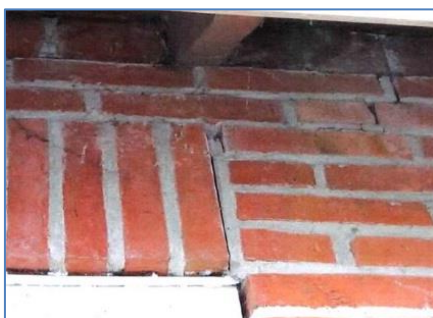
Figuren 7-38. De latei is slechts kort op de binnenmuur opgelegd. De rollaag met latei komt van hier los van het buitenspouwblad. De oplegging is meestal niet meer dan een halve baksteen lengte.
