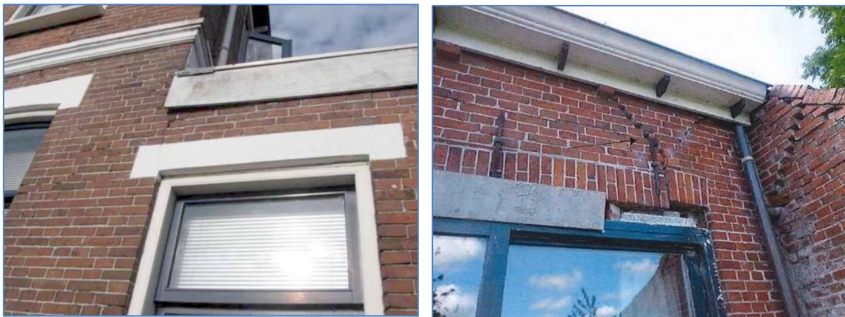
Figuren 7-53. Voorbeelden van verschillende oorzaken van schade rond lateien. Gebouw onregelmatigheid door een aanbouw zonder voldoende dilatatie of te korte oplegging.
