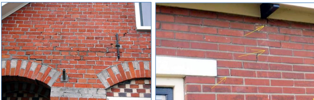
Figuren 7-54. Veel van de schademeldingen gebeurden n.a.v. scheuren rond lateien. Om de oorzaken weg te nemen is vaak een uitgebreider gebouw onderzoek naar de vloer-muur verbindingen noodzakelijk.
