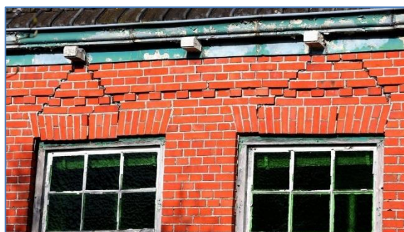
Figuur 7-1. Doorgezakte togen in steens-muur. Deze oude gebouwen hebben te lijden van langzame zettingen in de fundering en gebrek aan muurwapening. Foto rtl nieuws.
