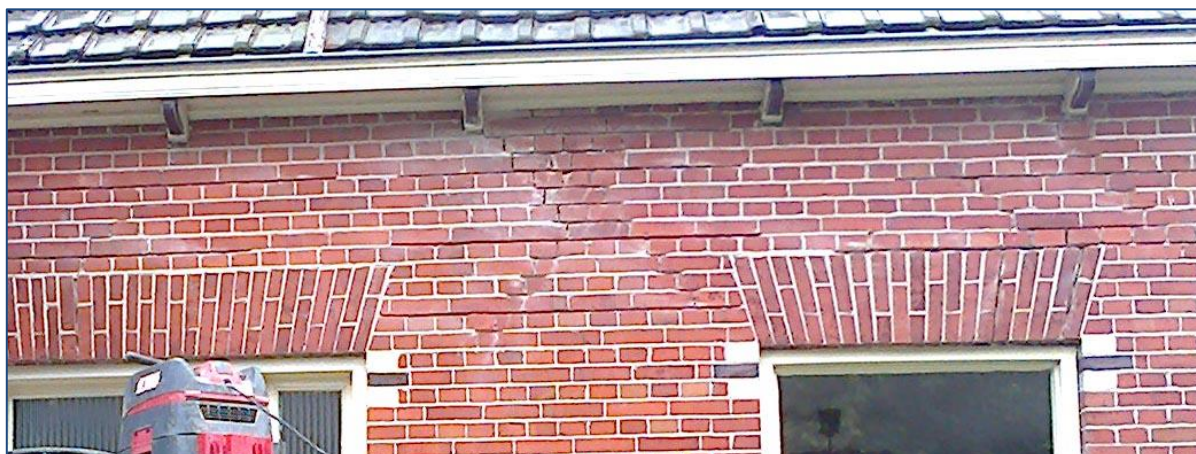
Figuur 6-92. Voorbeeld van een verkeerde toepassing van spiraalanker. Zowel boven het linker als rechter raam lopen de ingeslepen voegen of ankers niet door. Tussen die wapeningeinden zal de muur opnieuw scheuren.
