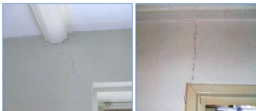
Figuren 6-93. Wegwerken is geen seismische versterking. Door bij binnenmuren slechts de scheur weg te plamuren, zonder muurversterking, ontstaat er bij de eerst volgende schok weer een barst.
