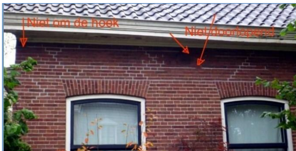
Figuur 6-94. Voltooid werk met niet-doorlopende rvs-wapening. In het midden is een onderbreking van de horizontale staaf van slechts enkele cm. Hier kan het gebouw dan opnieuw scheuren.
