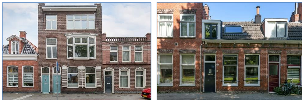
Figuren 6-70. Gebouwen die onvoldoende sterk moeten van elkaar gedilateerd. Zonder dilatatie, kunnen/zullen ze elkaar beschadigen.
