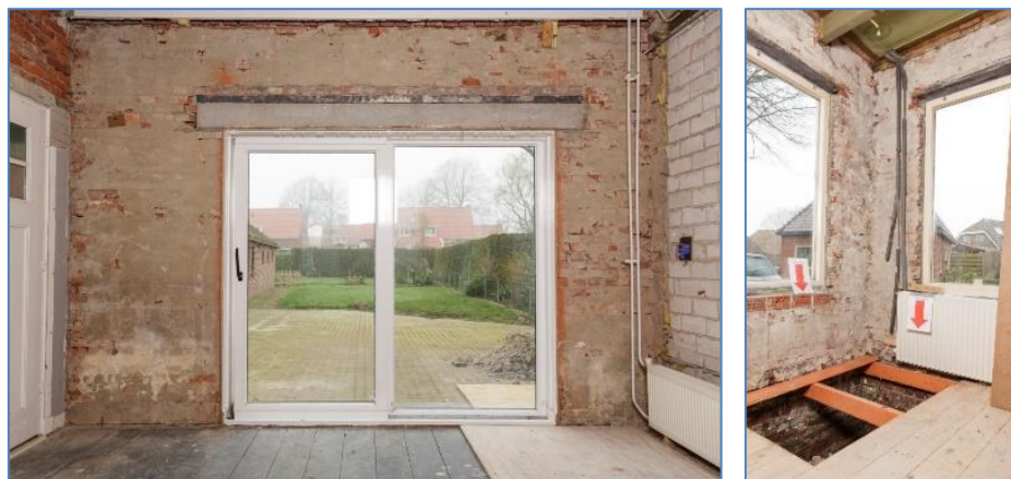
Figuren 6-62. Verschillende muurpenanten. Het linker muurpenant is breed genoeg om er een GVTW op te plakken. Bij smalle penanten kan in-frezen van trekwapening toegepast of hoekprofielen.
