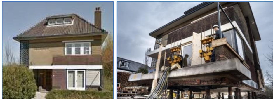
Figuren 5-52. Moderne historische villa met goede metselwerk kwaliteit. Dit gebouw kreeg een tweede betonnen fundering. Bij een PGAg 0,1 was er echter nauwelijks iets aan de hand. 29
