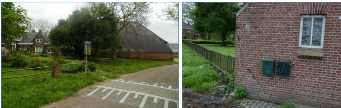
Figuren 4-33. In de aanvoerweg ligt hier een verkeersdrempel. Links . De rechterhoek van de schuur is verzakt vanwege de trillingen van zware vrachtwagens (van het eigen bedrijf?) die regelmatig vlak langs deze hoek rijden. Rechts . Aan de scheur is te zien dat deze vroeger al een keer is ingevuld. De verkeersdrempel heeft ook invloed op de andere verder weg staande boerderijgebouwen links.
