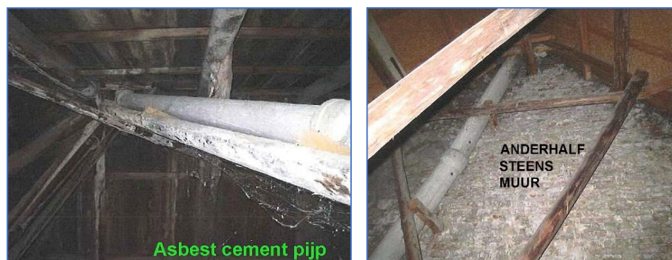
Figuren 3-46. Onder de schoorsteen zitten asbest pijpen voor ventilatie. Het is soms beter om de hele kapconstructie te vervangen en meteen goed te isoleren.
