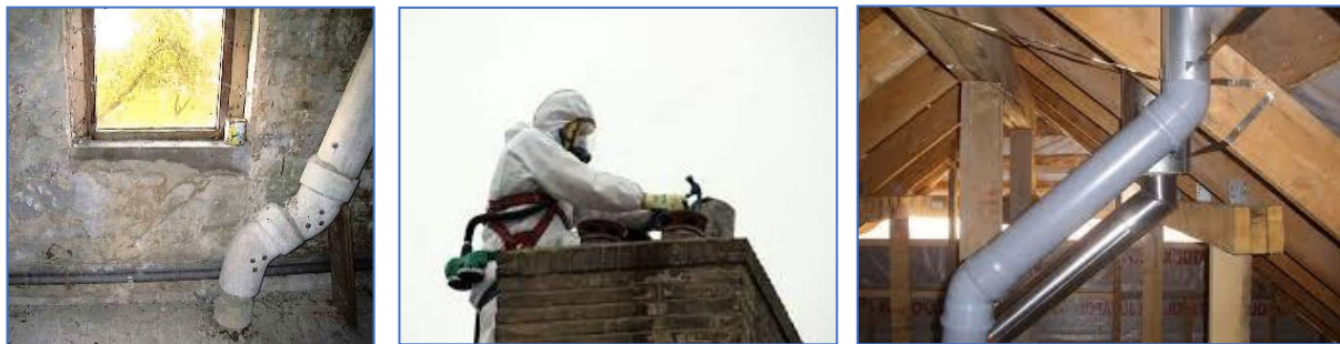
Figuren 3-47. Asbest ventilatiepijpen kunnen vervangen worden door Pvc-buizen. Ingemetselde asbest moet met zorg verwijderd zodat er geen stof bij vrijkomt (nathouden/verven).
