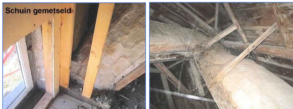
Figuren 3-43. Schuin gemetselde schoorstenen in houten kapconstructie. Deze moeten altijd verwijderd worden bij aardbeving risico's.
