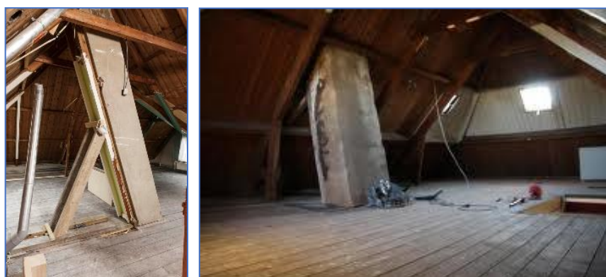
Figuren 3-45. Verslechte bakstenen schoorstenen zonder dragende muur. Het seismisch versterken van deze constructies is niet zinvol.
