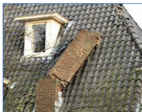
Figuur 3-16. Naar binnen gevallen schoorsteen. Bij belasting naar binnen is er een hoger scharnierpunt. De richting van vallen is afhankelijk van de richting van de aardbeving.
