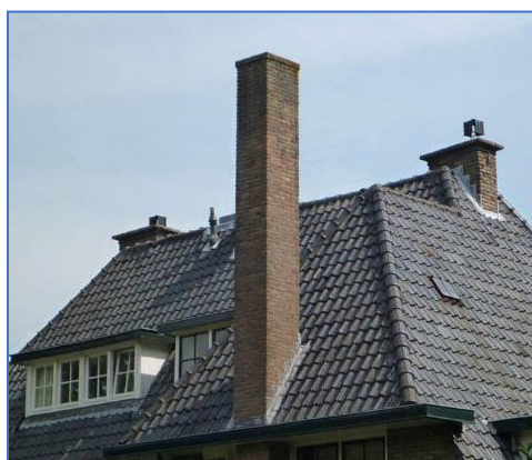
Figuren 3-17. Hoge schoorsteen. Voorbeeld van een schoorsteen die omvalt bij een PGA_g 0,1 beving. Het is alleen niet zeker naar welke kant. Vervangen door een lichte roestvrij stalen sandwich buis tot boven de nok is hier een optie.
