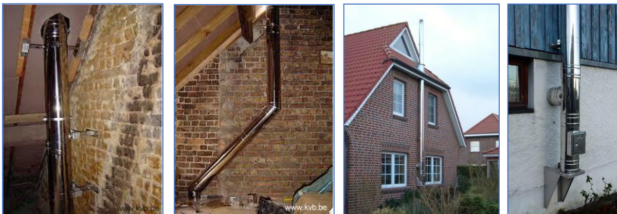
Figuren 3-58. Dubbelwandige, geïsoleerde rvs-schoorstenen. Links. Hier is te zien dat de oude schoorsteen van de tussenwoning muur is verwijderd. Rechts. Buitenom.
