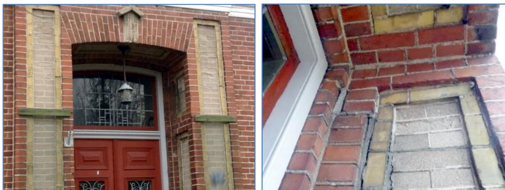
Figuren 2-27. Woning met een teruggezette entree. Dit komt veel oor. Door deze kleine onregelmatigheid ontstaan al veel scheuren.
