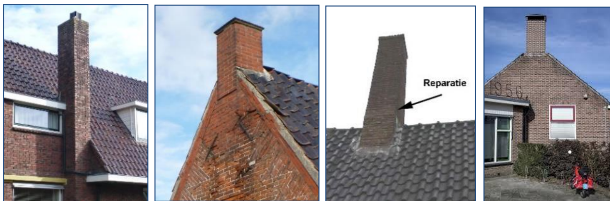
Figuren 2-48. Voorbeelden van risicovolle schoorstenen.
