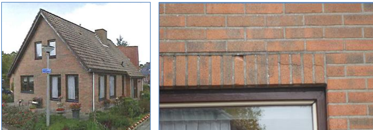
Figuren 2-36. Scheuren in de latei vanwege torsie.
