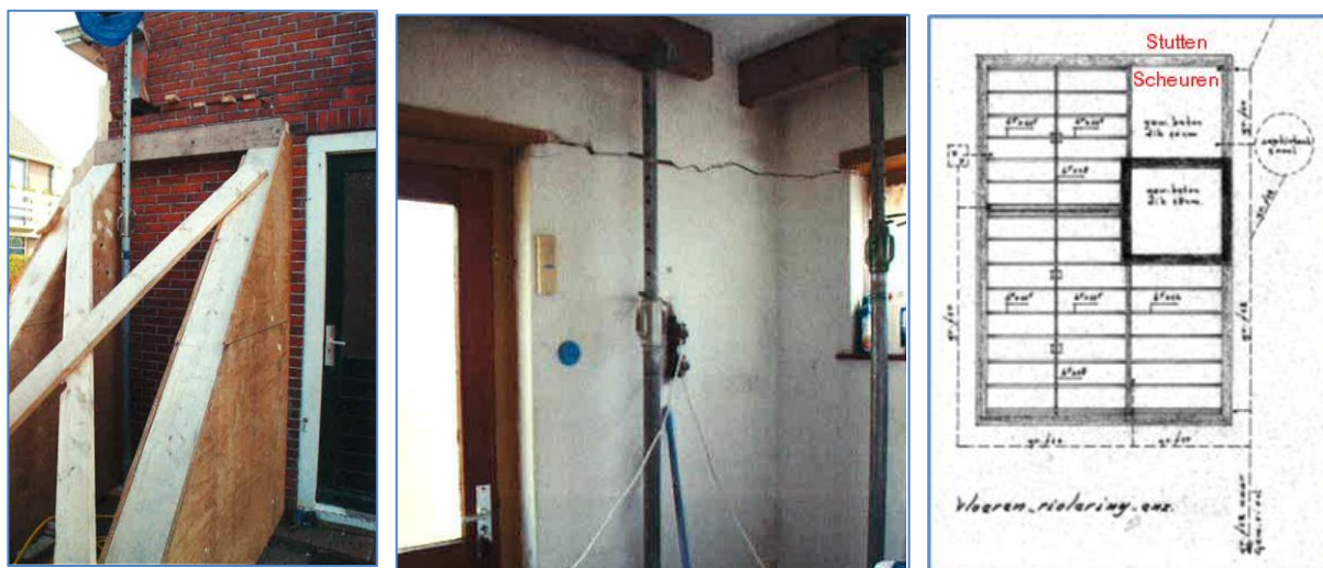
Figuren 2. Opname van de schade aan de buitenmuur van de bijkeuken en binnen. De plattegrond van de begane grond geeft de positie van de kelder aan en de locatie van de scheurvorming in de gevel. Stempels.
