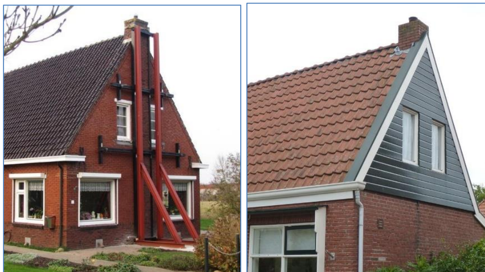
Figuren 16. Door de twee bakstenen geveltoppen en schoorstenen te verwijderen en te vervangen door een houten top, wordt de massa minder en kan er geen breuklijn op de etagevloer ontstaan. In de rechter foto zit de schoorsteen er nog, maar zal binnen wel gebarsten zijn.
