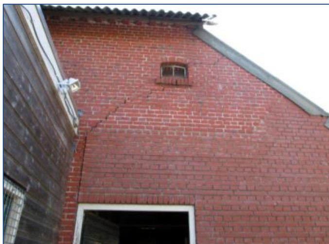
Figuur 10-32. De vroegere grote deur werd gedeeltelijk dichtgemetseld. Boven de kleinere deur is de dag van de oude deur zichtbaar als scheur. Die scheur loopt via het raampje naar de dakrand. Mogelijk is de fundering verzakt vanwege de grotere muurmassa.
