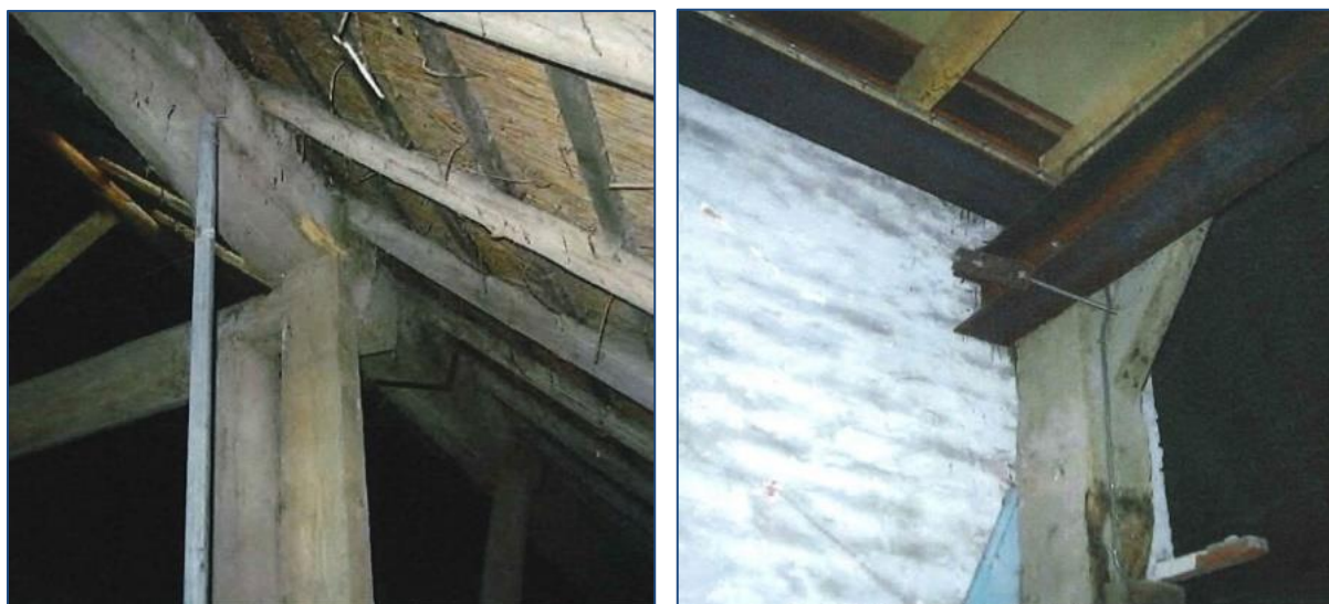
Figuren 10-21. Versterkingen langs de gebinten. Veel schuren zijn nog in gebruik als opslag of parkeerruimte. Enkele versterkingen zijn met hout (links) of ijzer (rechts). De oude constructies vervangen is een kostbare aangelegenheid.
