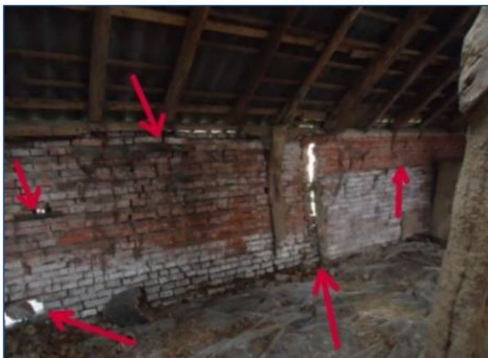
Figuur 10-37. Zijmuur is halfsteens opgebouwd gedurende verschillende fasen. Deze muur is vergaand in verval. Op verschillende plaatsen kan je door de gebroken muur naar buiten kijken. Bij in gebruik zijnde schuren worden deze muren gewoonlijk onderhouden.
