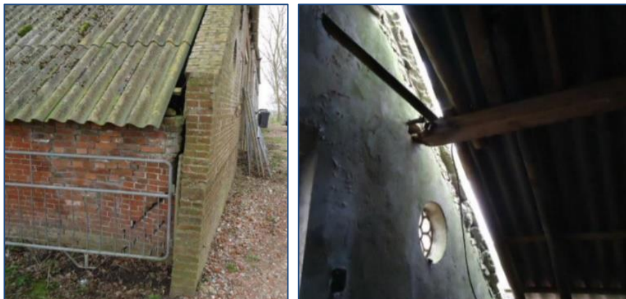
Figuren 10-22. Buiten- en binnen aanzicht van een losgekomen kopgevel. Dit is ten dele vanwege het doorrotten van de jukplaatverbindingen aan die buitenmuur (rechts).
