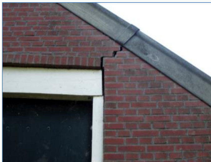
Figuur 10-33. Scheur op de zwakste doorsnede. Hier is waarschijnlijk ook het wegdrukken van de zijmuur ook de oorzaak. De kozijnstijl onder de bovendorpel opzijgeschoven. De rechter schets van figuur 10-31 zou hier ook van toepassing kunnen zijn. Aan de invul baksteentjes boven de deur
