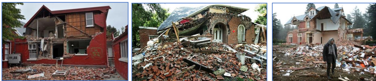
Figuren 1-60. Deze gebouwen zijn in de DS4 (net niet ingestort) en DS5 fase (ingestort), terwijl ze wel volgens de code seismisch bestendig waren gebouwd. Mw 6,2 en diepte slechts 5 km en een 15 km lange zone met PGAg \approx 0,22 verticaal en PGAg 0,17 horizontaal in het epicentrum. In de stad zelf waren de PGAg 0,08 verticaal en PGAg 0,07 horizontaal, vergelijkbaar met de 16-08-2012 Huizinge beving, maar dan veeeeeeeel langer van duur.
